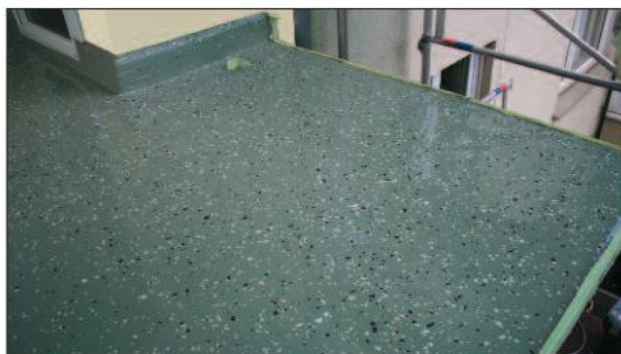
ENKETOP-lattia, joka on vähän chipattu
